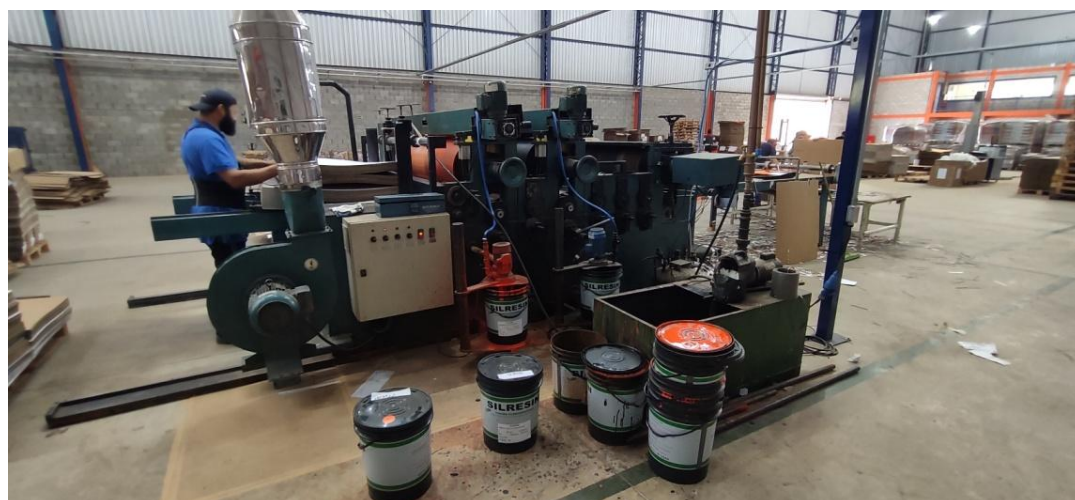
Figura 6 . Inserção de tintas e tanque de retorno de efluentes da máquina de impressão/pintura.
