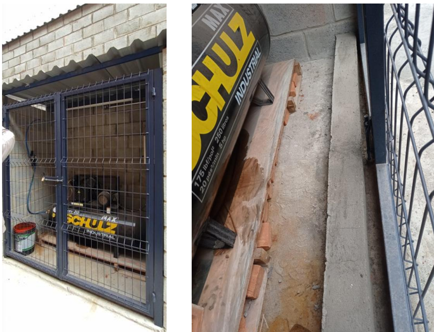
Figura 22. Compressor de ar utilizado e evidencia de contenção.
