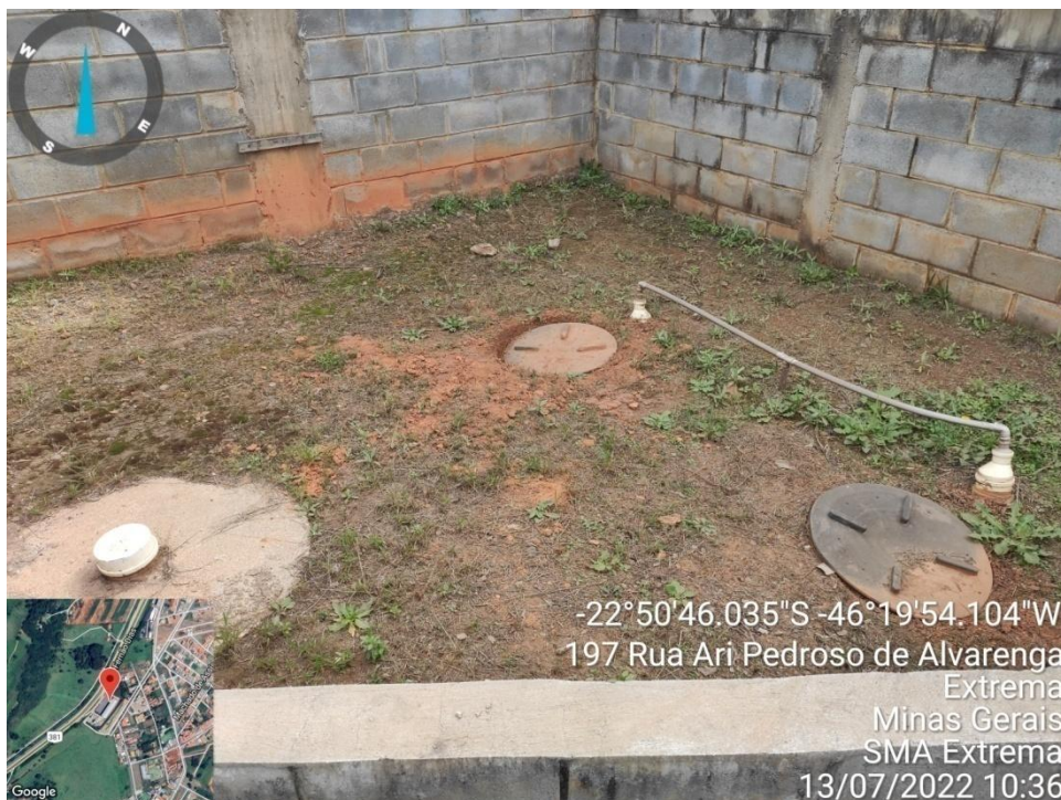
Figura 25. Sistema de tratamento de efluentes sanitários (fossa séptica e filtro) e sumidouro.
