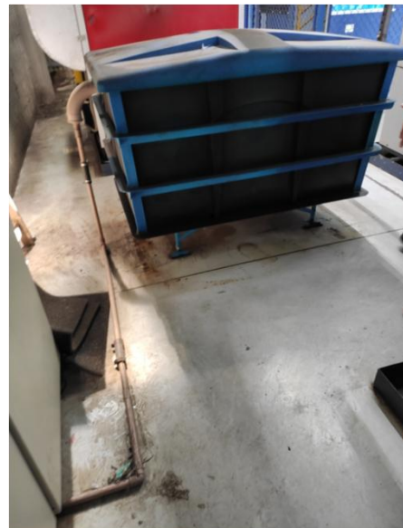
Figura 9. Tubulação de saída do sistema SAO
