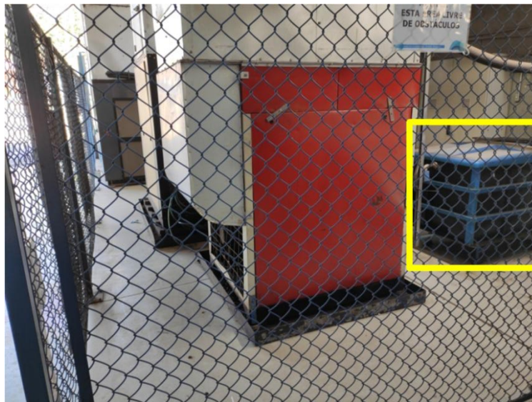
Figura 7. Área de compressores, com destaque para o sistema separador de água e óleo (SAO)
