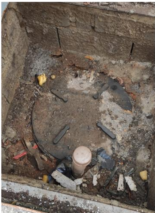
Figura 7. Ponto de entrada do sistema de tratamento de efluente.
