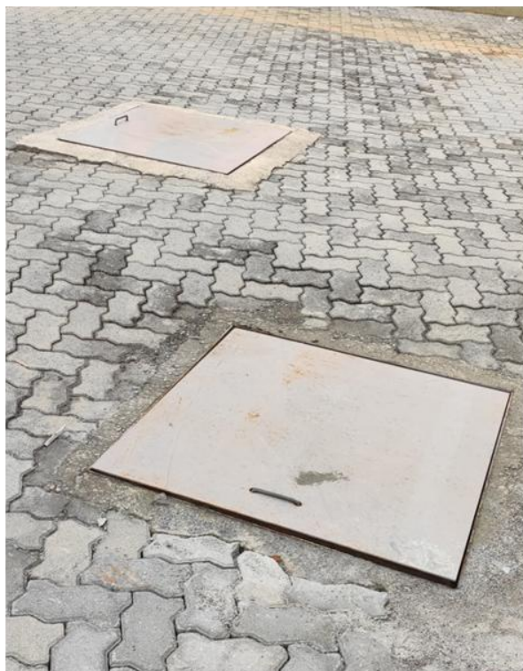
Figura 09. Local de entrada e saída do sistema de tratamento de efluente.
