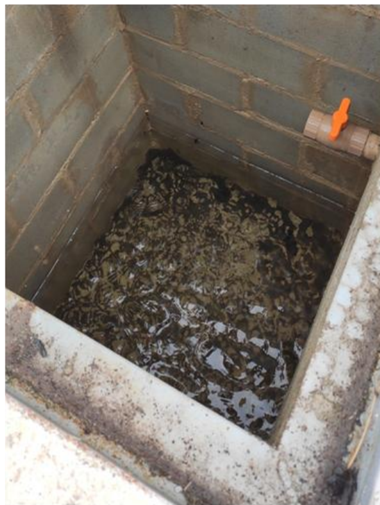
Figura 8. Ponto de saída do sistema de tratamento de efluente.
