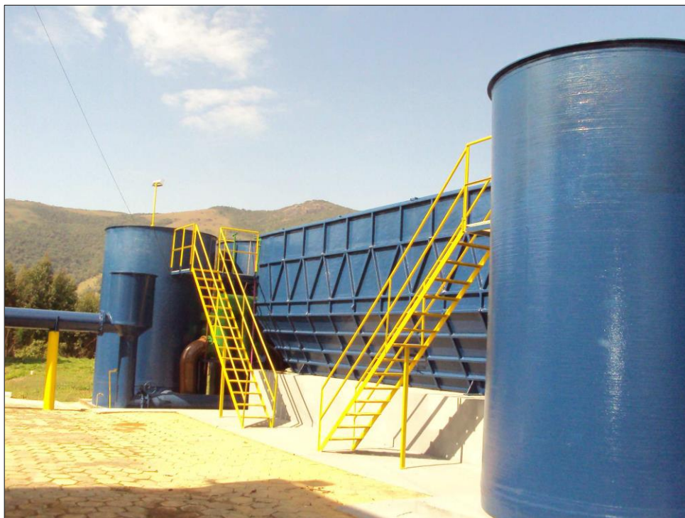
Figura 6 - ETA de fibra (Extrema)
