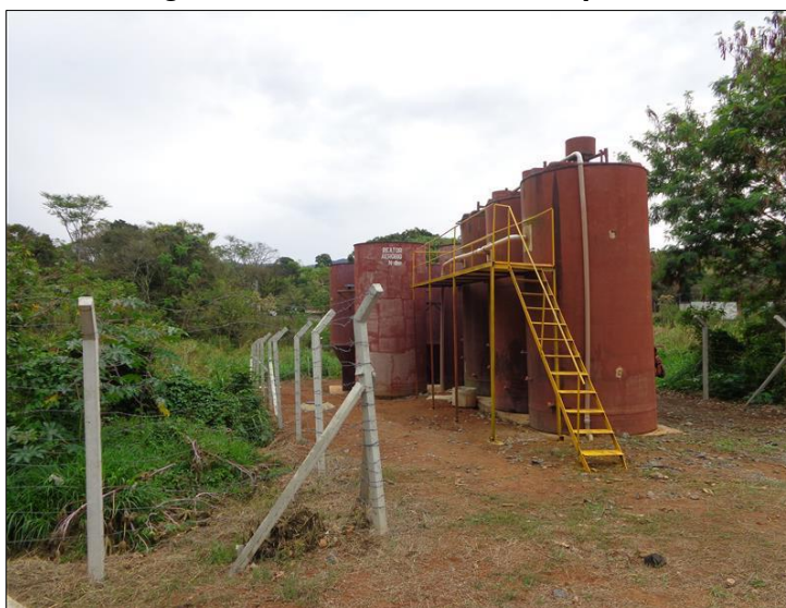
Figura 19 - ETE Jardim Mantiqueira
