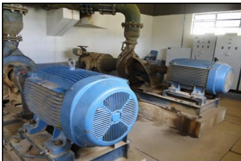
Figura 3 - Estação Elevatória Sistema Jaguari
