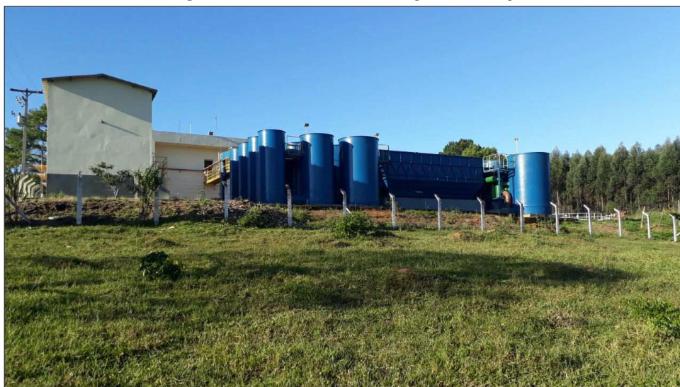
Figura 5 - ETA de fibra (Extrema)
