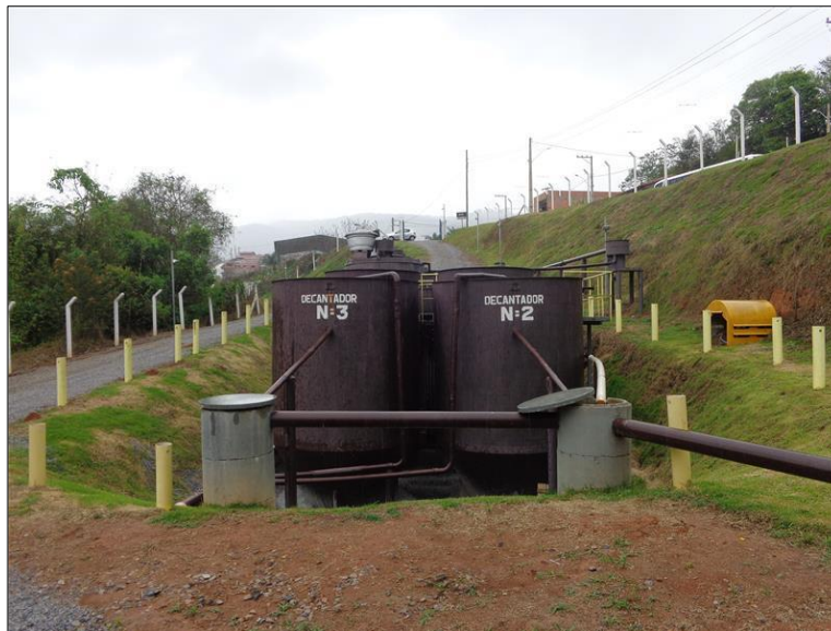
Figura 16 - ETE Roseiras - Decantadores secundários
