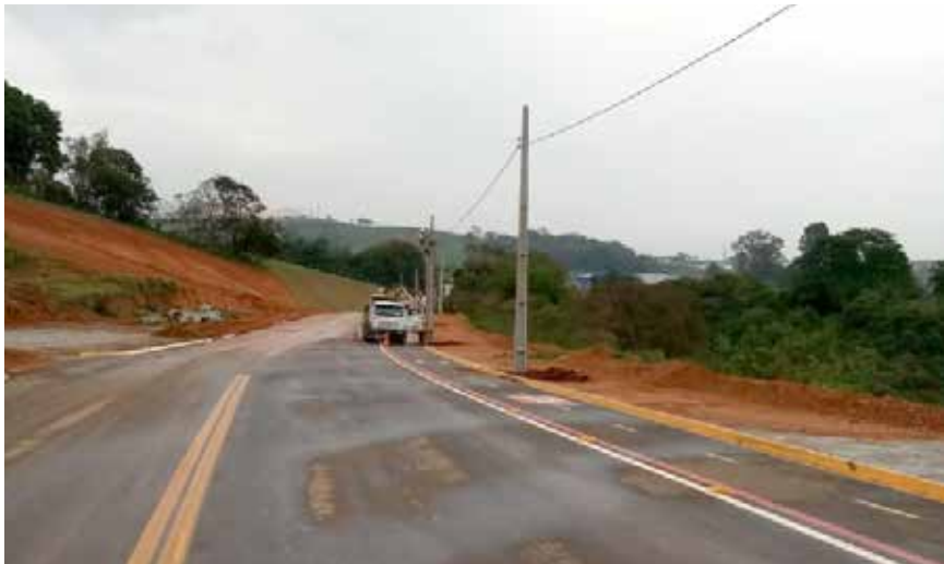
Posteamento e iluminação na Av. Saes Peres (entrada para o Parque de Eventos)
