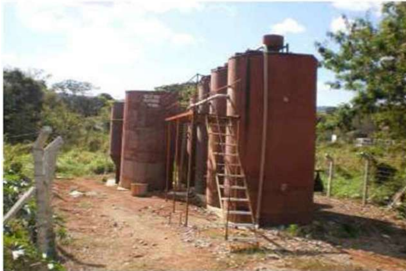
Reatores em fibra ETE Jardim Mantiqueira
