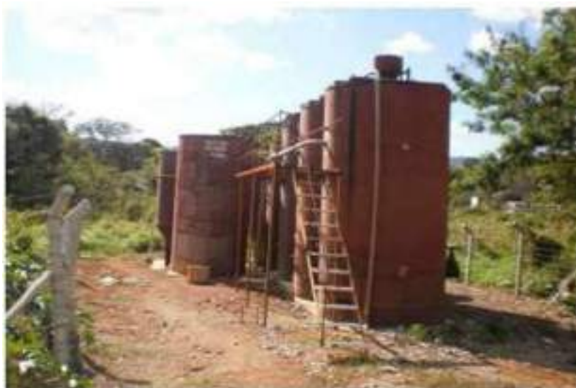
Reatores em fibra ETE Jardim Mantiqueira
